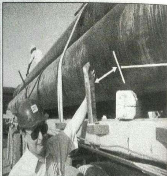
شکل ۵.۱۵ عدم مهار بار و سقوط بار
